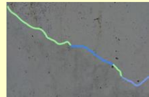
AIにより検出されたひびわれ
