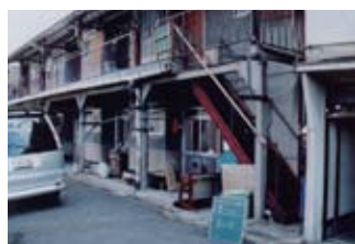
【老朽化した共同住宅】
