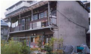
老朽化した共同住宅
