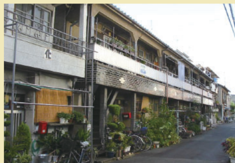
阪神・淡路大震災では死者6,400人のうち約8割が建物の倒壊が直接の原因となっています。
