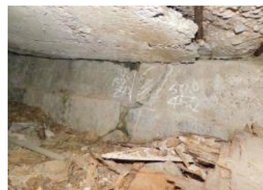
【下部工】ひび割れ
