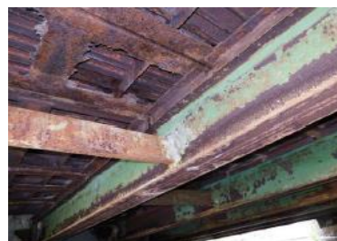
【床版】腐食、破断
