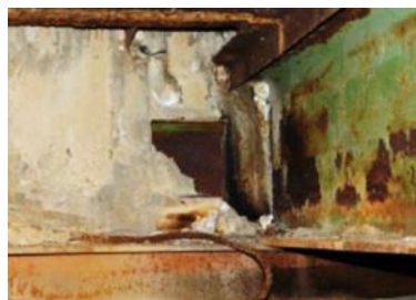
【主桁】塗装劣化・腐食、横桁の破断
