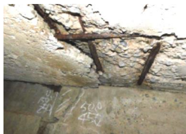
【床版】剥離、鉄筋露出
